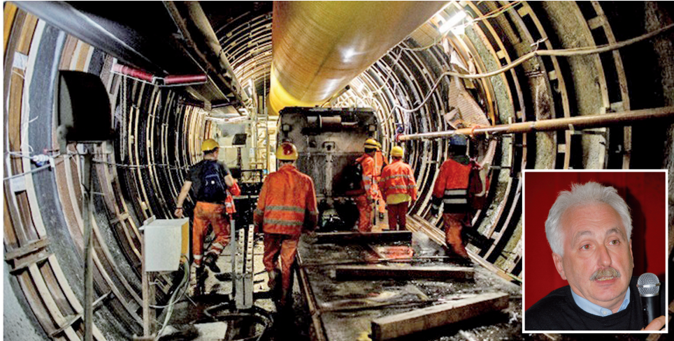
I lavori in corso nelle gallerie geognostiche della Torino-Lione. Nel riquadro: Paolo Foietta
