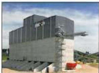
Figura 38 – Impianto di valorizzazione dei materiali di scavo – Particolare della tipologia di schermatura contro rumore e polveri
