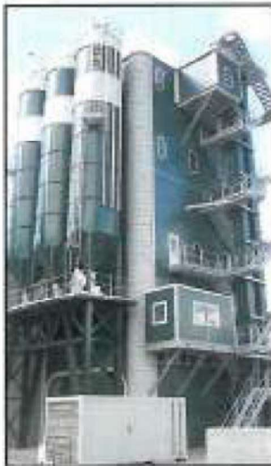
Figura 35 – Impianto di betonaggio con silos verticali – Particolare della tipologia di schermatura contro rumore e polveri
